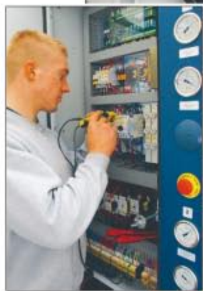
Kälteanlagenbauer Sören Meier überprüft die Wärmetauscher einer Kühlanlage.
